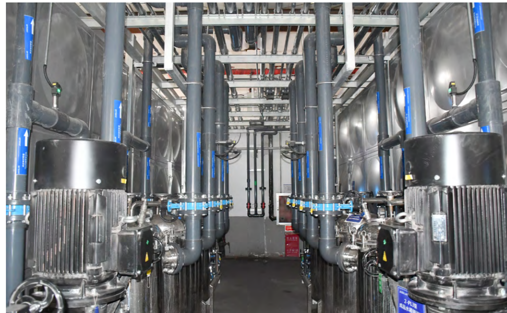
水循环处理系统 Water recycling and reuse equipment
